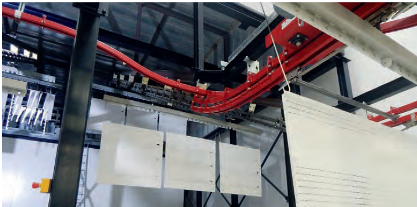
Steigung und Gefälle mit 30° in den A-Trockner, der in der zweiten Hallenebene angeordnet ist.
