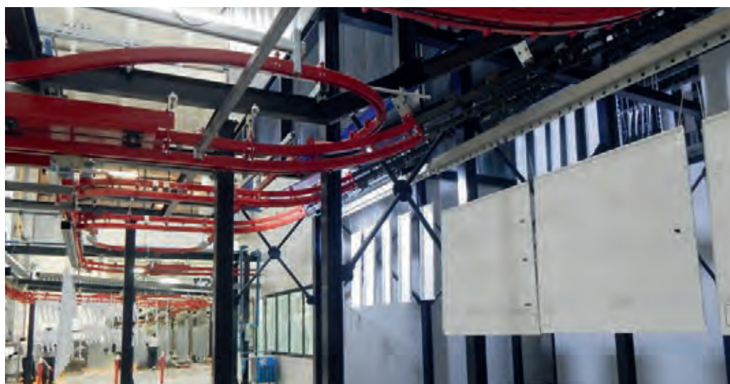
Der P+F Förderer ist trotz des maximalen Gehängewichts von 200 kg als leichtes System ausgelegt, um die Energiemenge in den Trocknern zu reduzieren; hier der Blick in die Kühlzone.
