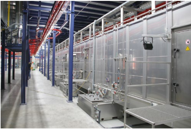
Die Vorbehandlung mit klassischer Eisenphosphatierung ist ausgelegt für Substrate aus Aluminium, Stahl und verzinktem Stahl. Eine sechste Zone für eine mögliche Umstellung auf ein alternatives Verfahren ist integriert.
