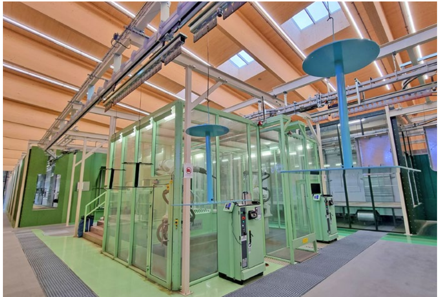
Der P&F 400 Hängeförderer verfügt über 65 Laufwagen mit je 500 kg Traglast und führt auch durch die Lackierkabine, Vorbehandlung und den Einbrennofen. Appliziert wird mit Dichtstromtechnik.
