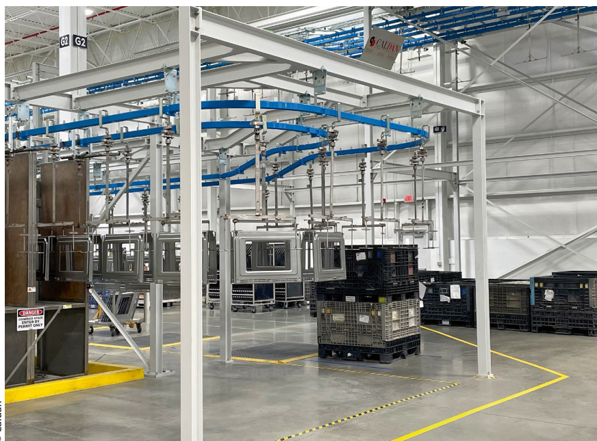
Der Kreisförderer ist nach unten geschlossen, damit kein Schmutz aus dem Förderer auf das Substrat gelangt.
