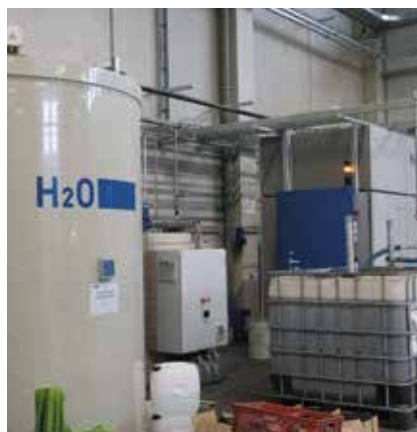
Dank Verdampfer, Umkehrosmose und Ionentauscher schont die Anlage die Umwelt und Reku spart Entsorgungskosten.
