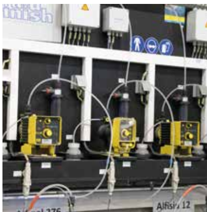
Regelmäßige Messungen der Badparameter sowie eine automatisierte Dosierung halten die Vorbehandlung auf hohem Niveau.
